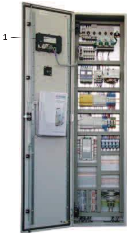
Schaltschrank Kombi Automatiskab Kombi
