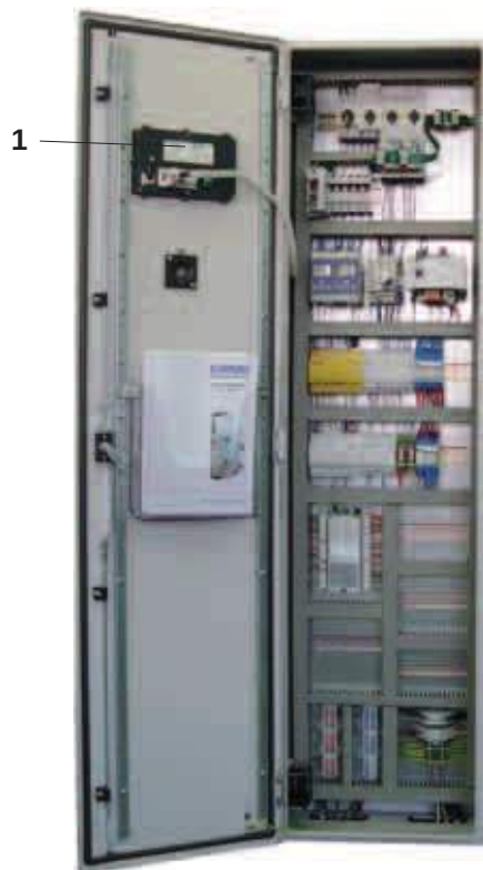
Schaltschrank Gasfeuerung Automatiskab gasfyring
