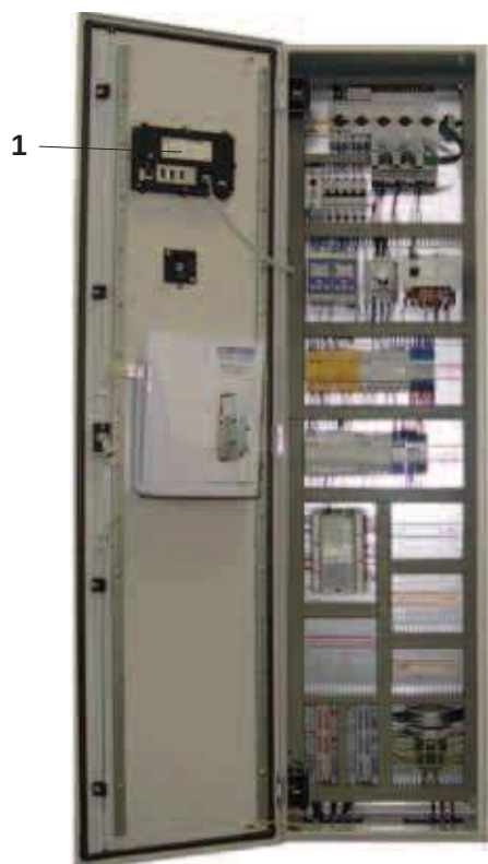
Schaltschrank Ölfeuerung Automatiskab oliefyring
