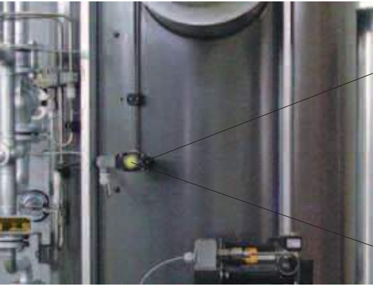
Luftdruckwächter Hauptbrenner Luftmangelsikring hovedbrænder
