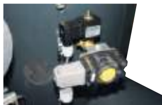
Magnetventil Luftdruckwächter Magnetventil, luftmangelsikring
